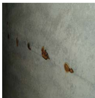
写真-3 旧高負荷ばっ気槽躯体劣化状況
