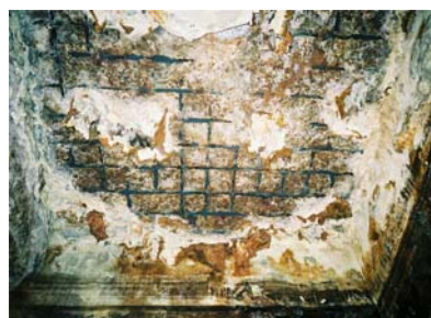
写真-4 第三流量調整槽躯体劣化状況
