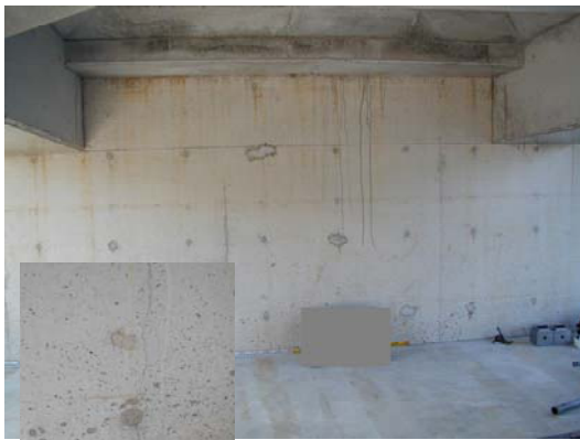
壁体中央にひび割れ (拡大)
